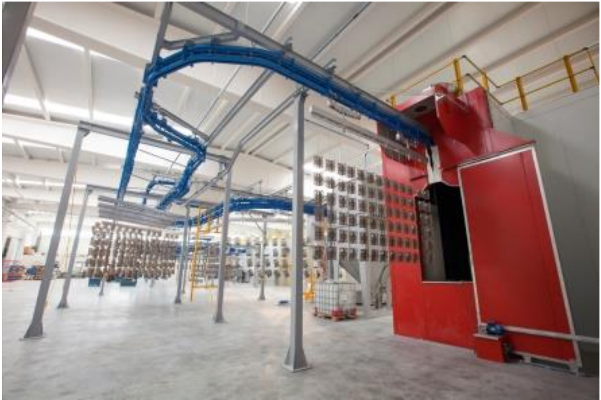
Salida del horno desecado de humedad
