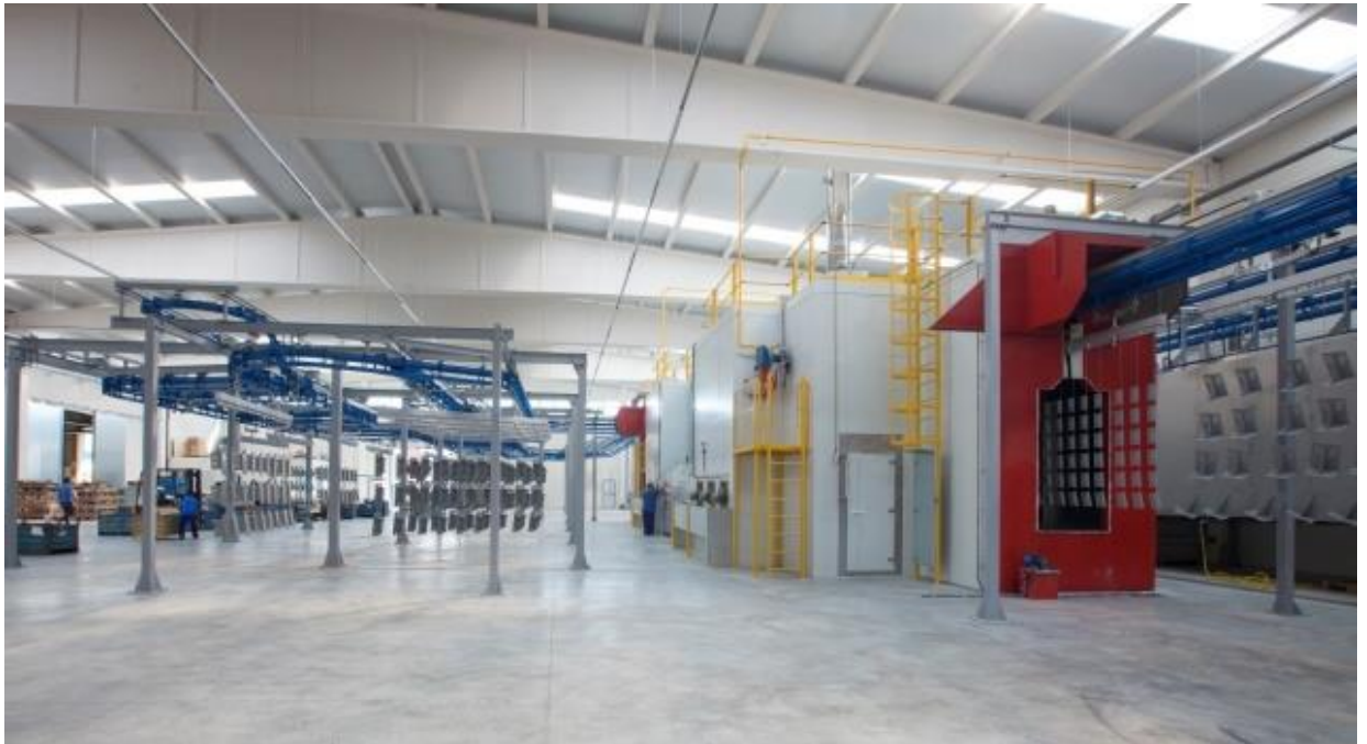
Salida del horno desecado de humedad
