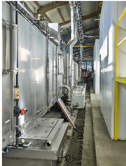
Pie de fotografía. Foto 2.- Vista lateral del túnel de tratamiento
